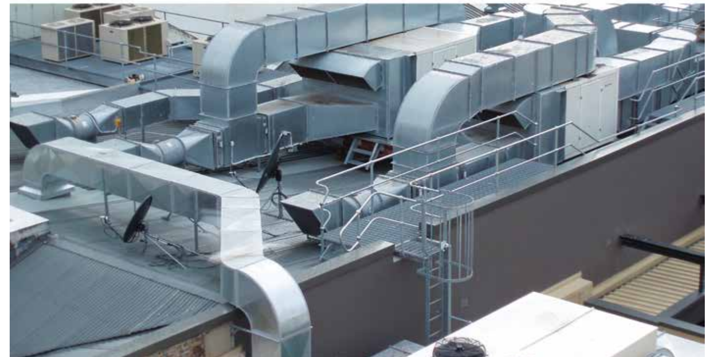
Ống thông gió / Duct Pipes
